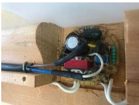
Εικόνα 6: Σύνδεση και τοποθέτηση σε ξύλινη βάση
