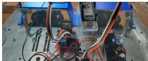
Εικόνα 13. Τοποθέτηση H bridges και step down dc-dc converters στη ρομποτική πλατφόρμα 4WD.
